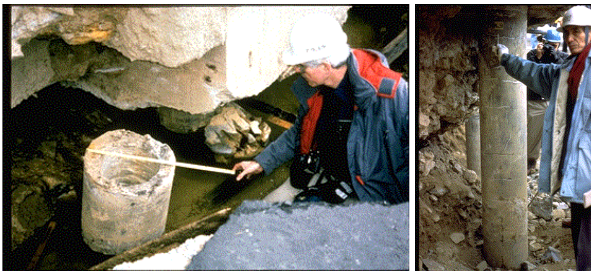
شکل ۸-۲- خرابی شمع‌ها در اثر گسترش جانبی در طی زلزله‌ی کوبه در ژاپن
