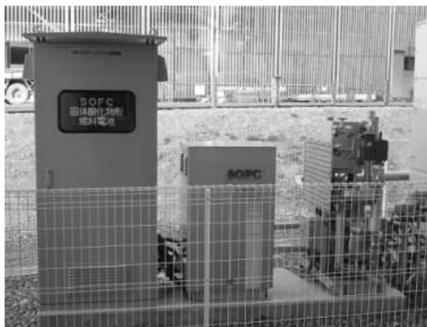
شکل ۲-۴۴: سیستم یک کیلووات CHP پیل سوختی اکسید جامد ساخت کمپانی Nippon-Shokubai Co., Ltd. [۲۷]
